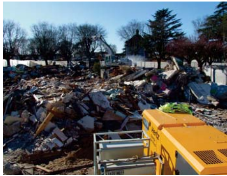
Il aura suffi de quelques heures aux engins pour mettre à bas la crèche.
