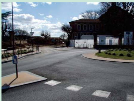
Le nouvel accès au site se dessine: la conciergerie provisoire est en préparation
